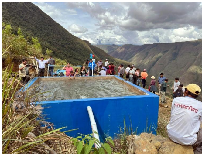
Uno de los dos depósitos de agua con una capacidad de 10.000 litros.
